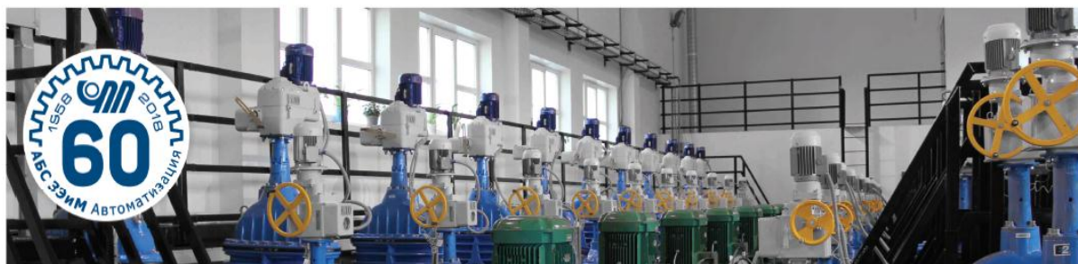
Электрорывовые «АБС ЗЭИМ Автоматизация» на ОАО «Водоканал», г. Чебоксары.
